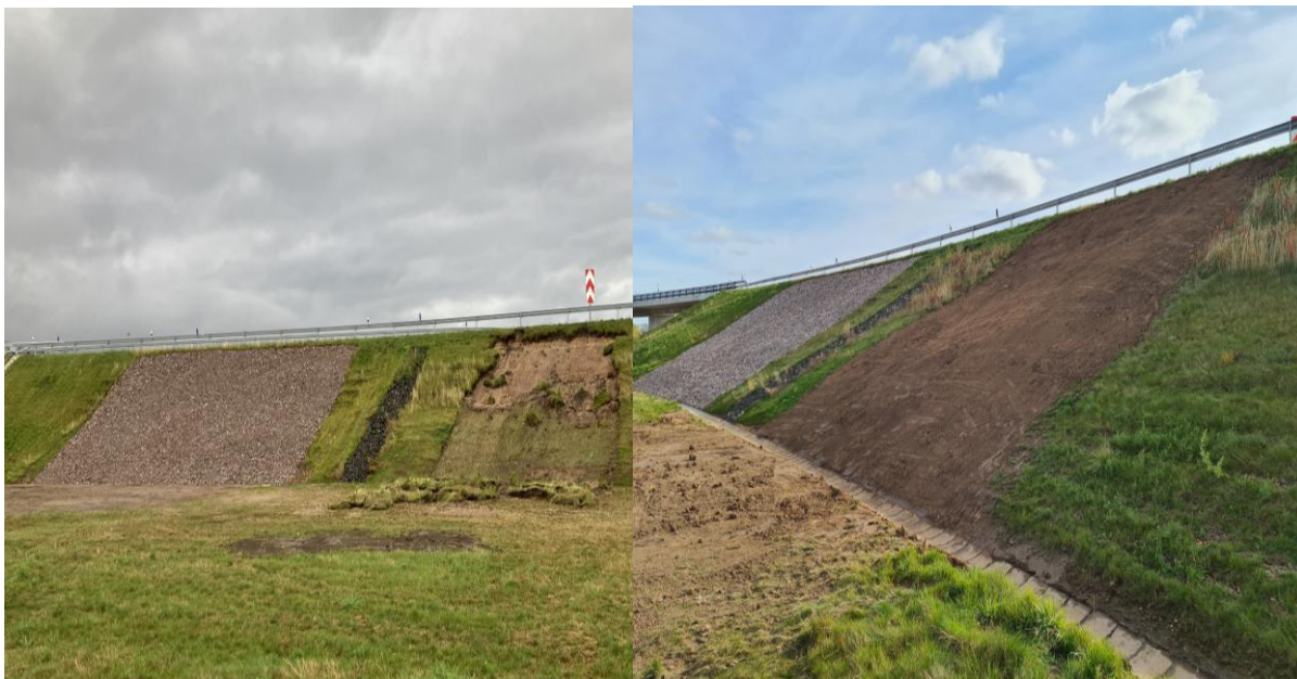
Obr. 2 Opakovaný vznik povrchových deformací a jejich sanace – (a) druhé poškození povrchové vrstvy násypu po intenzivních srážkách v srpnu 2024, (b) sanace sesuvné lokality v říjnu 2024.
